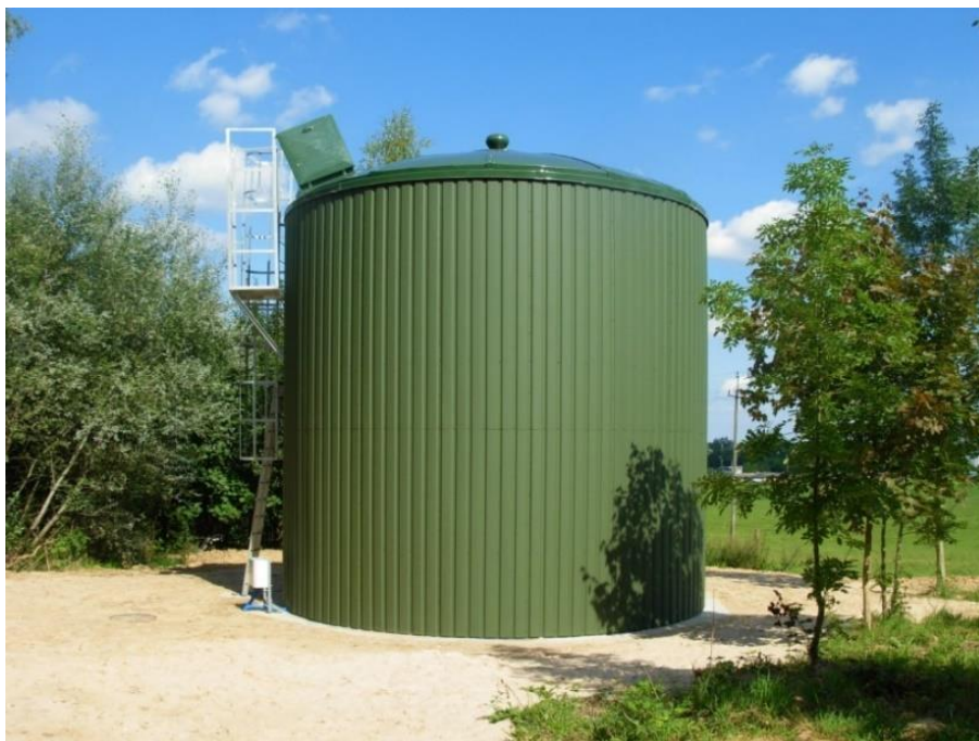
Rysunek 1. Widok zbiornika retencyjnego wody czystej
